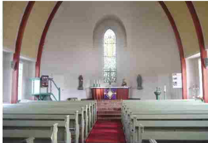
Der Innenraum der Sankt Jakobuskirche erhält eine neue Elektroheizung, Induktionsschleifen für Schwerhörige...
