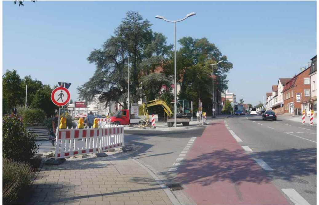
In Kürze übernimmt eine neue Ampelanlage die Verkehrsregelung Deutenbacher Straße / Hauptstraße
