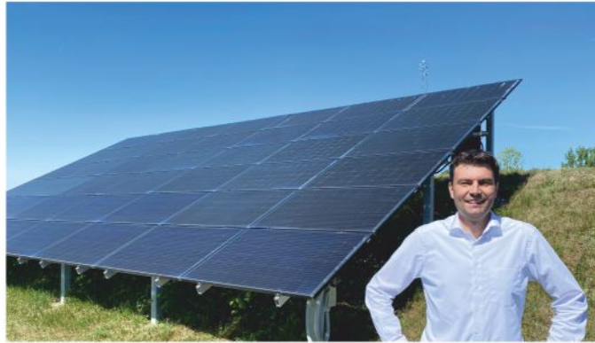
PV-Anlage am Steiner Wasserwerk mit Stadtwerkeleiter René Lukas
